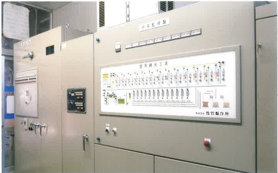
●コンピュータ集中制御管理室
